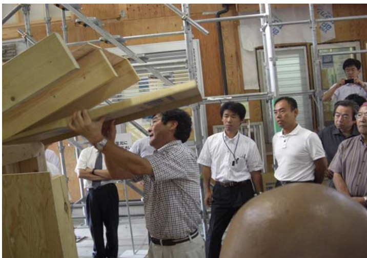
写真は屋根断熱の通気層部品を施工する場面。ここに高性能グラスウール150mm施工される。 PM5:00終了
