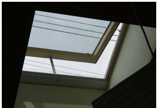
夏は、夏専用の換気扇とセットで天窗をフル活用。この窓の電動耐用を心配している。
